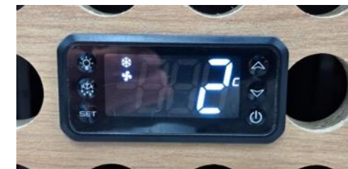
Lectura de temperatura de la isla refrigerada
